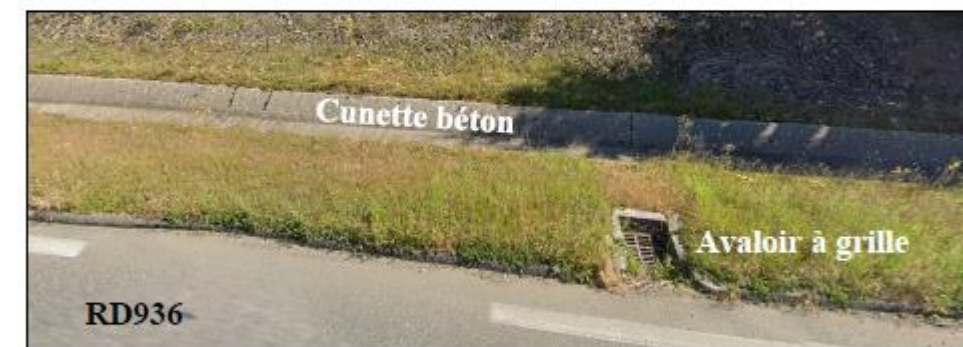
Figure 11 : Illustration d'avaloirs à grille et de la cunette béton, situés en bordure de la RD936, observés le 13/01/2022
